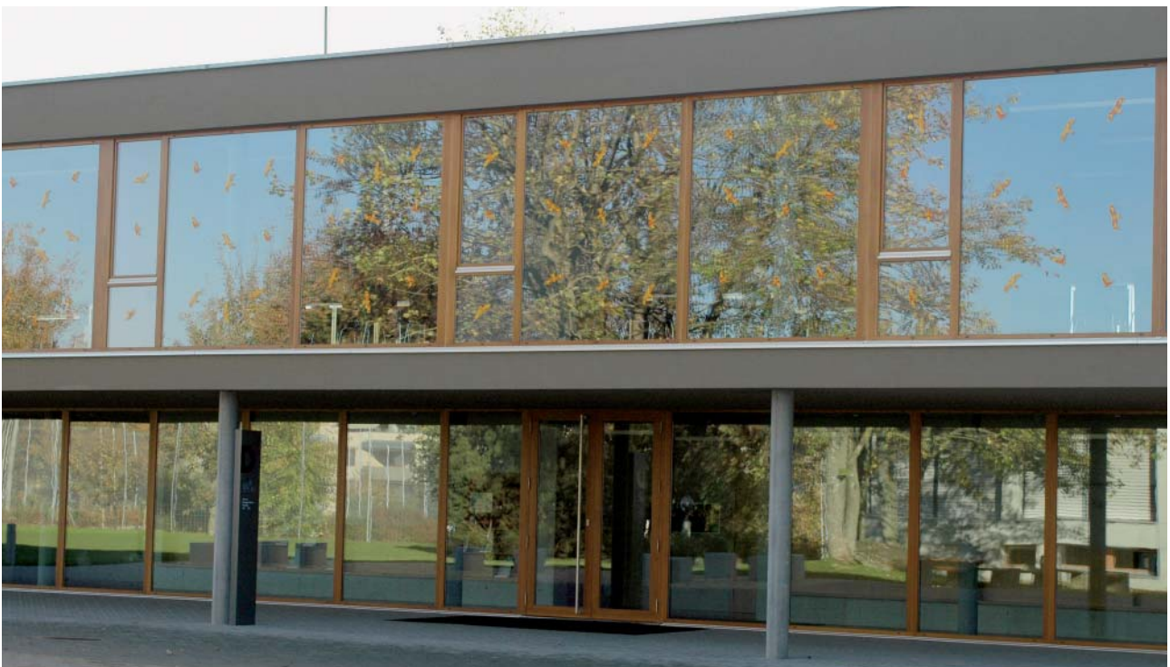
Ein Schulhaus-Neubau mit einer breiten, zweigeschossigen Glasfront. Wegen des eingesetzten Glases mit hohem Reflexionsgrad kam es dauernd zu Kollisionen. Die farbigen Silhouetten wurden von den Schülern und den Biologielehrern in einer «Verzweiflungstat» angebracht. Die Kollisionsgefahr wurde damit etwas gemildert, doch das Problem ist weder ästhetisch befriedigend noch wirkungsvoll behoben.
