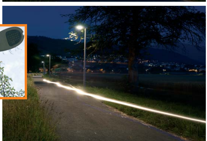
Ein Fuss- und Radweg, ausgerüstet mit neuesten Beleuchtungsmitteln, die mit Bewegungsmeldern gekoppelt sind. Erst wenn ein Radfahrer vorbeifährt, wird die minimale Beleuchtung hochgefahren.
